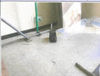
35. 음압기배출구19 (3층 1구역) (동춘관)
