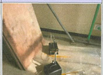
32. 음압기배출구16 (3층 1구역) (동춘관)
