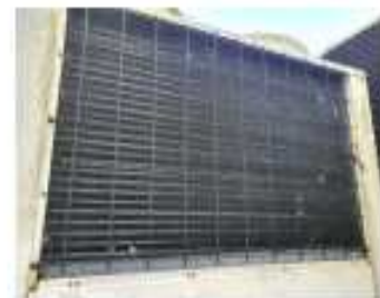
<히트펌프 실외기 먼지 쌓임>
