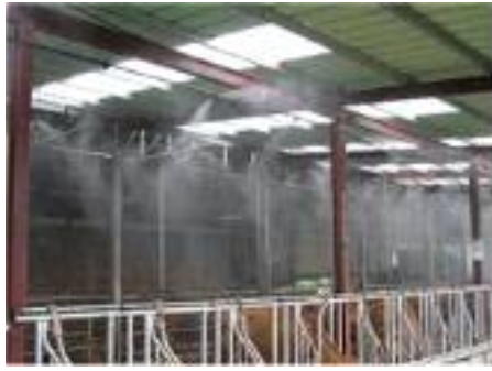
<축사 내부 스프링쿨러>
