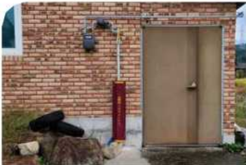
| 세대 내 배관 및 계량기 |
